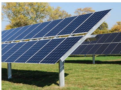
Solcellepaneler på stativer med tracker-mekanisme.
